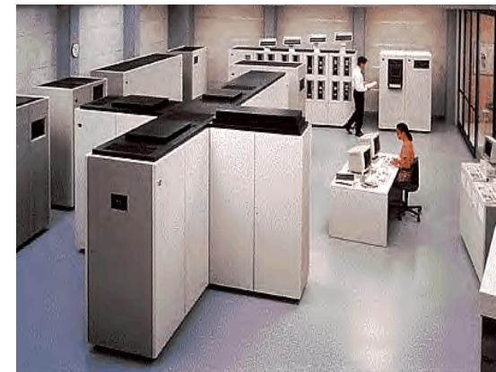
Sala de control de mainframes
